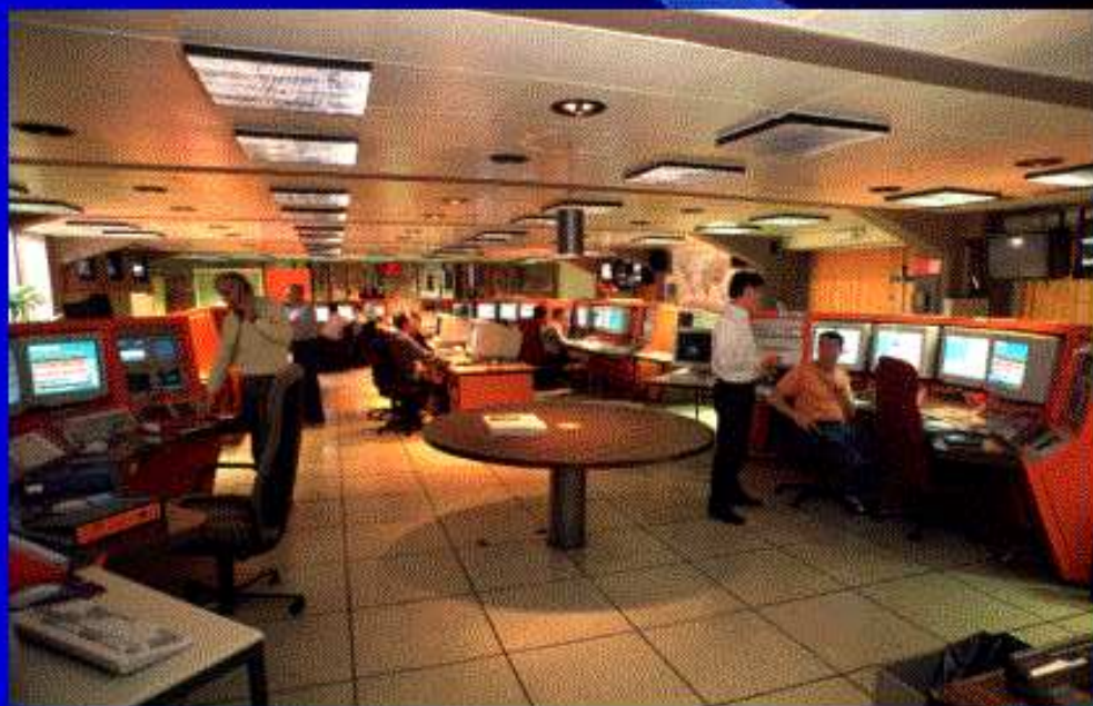
PS Kontrollraum (CERN, Genf)
